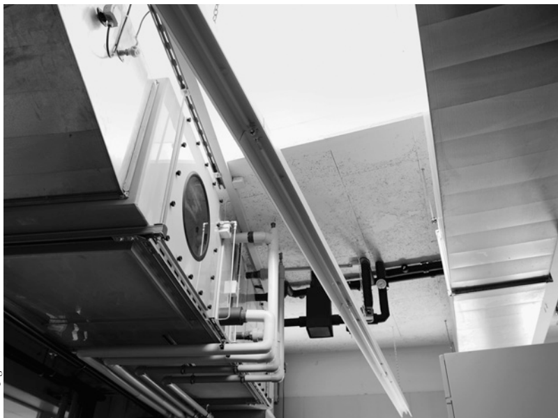
Die EPMS-Anlage ist für Wasseraufbereitung, Reibertemperierung und Kälteerzeugung für die Klimatisierung verantwortlich.
